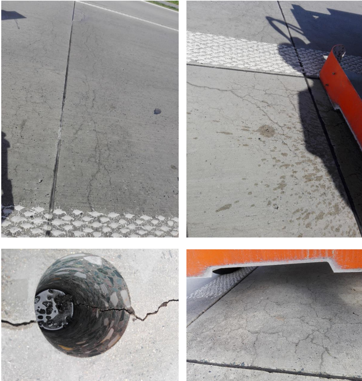
Rys.1.1. Widok spękań powierzchni drogi S8 w tych miejscach, w których pobrano próbki odwierty (zdjęcia wykonane i udostępnione przez Laboratorium Drogowe GDDKiA O/Łódź)
