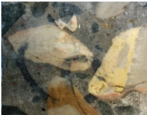
Rys.6.5 Odpryski ziaren kruszywa kwarcytowego wskutek przechowywania próbek betonu w 1 N roztworze NaOH w temperaturze 80°C.
