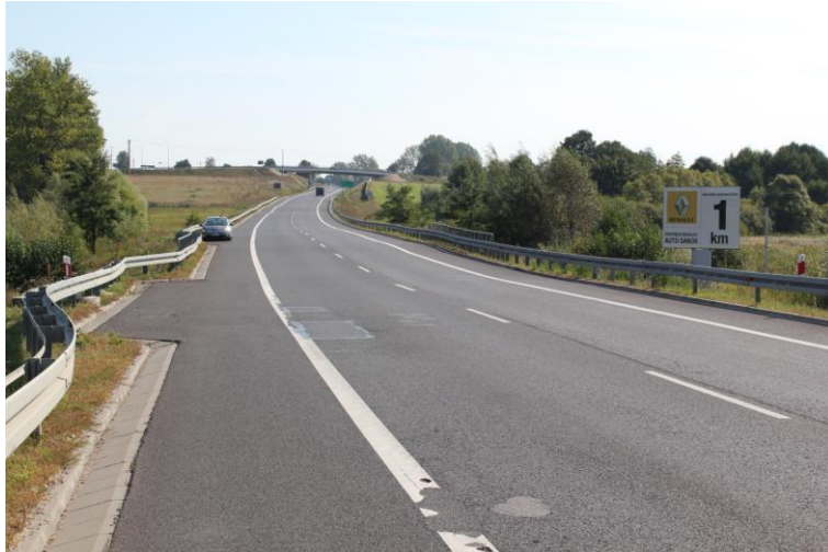
Rysunek C.27. Obwodnica Gniezna km 4+700, widoczne nierówności podłużne trasy oraz łaty
