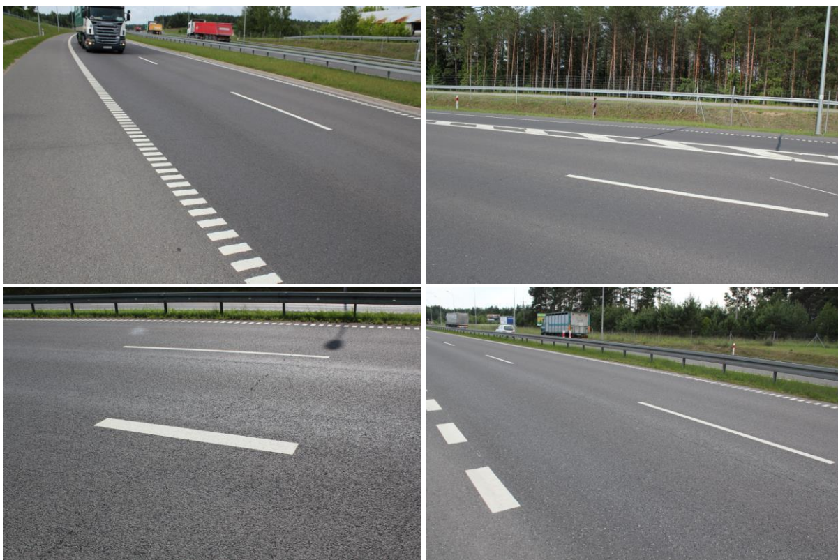
Rysunek C.14. Stan nawierzchni odcinka DK8 oceniony w roku 2012 a) spękanie poprzeczne o niskiej szkodliwości; b) spękania poprzeczne i naprawione spękania poprzeczne/szwy robocze; c) spękanie poprzeczne; d) spękanie podłużne
