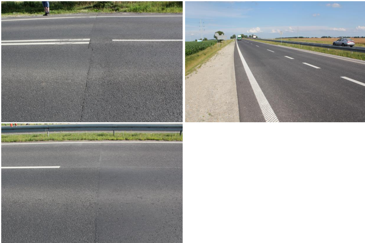
Rysunek C.3. Stan nawierzchni odcinka DK35 oceniony w roku 2012 a) początek odcinka, b) widok ogólny, c) zamknięty szew roboczy
