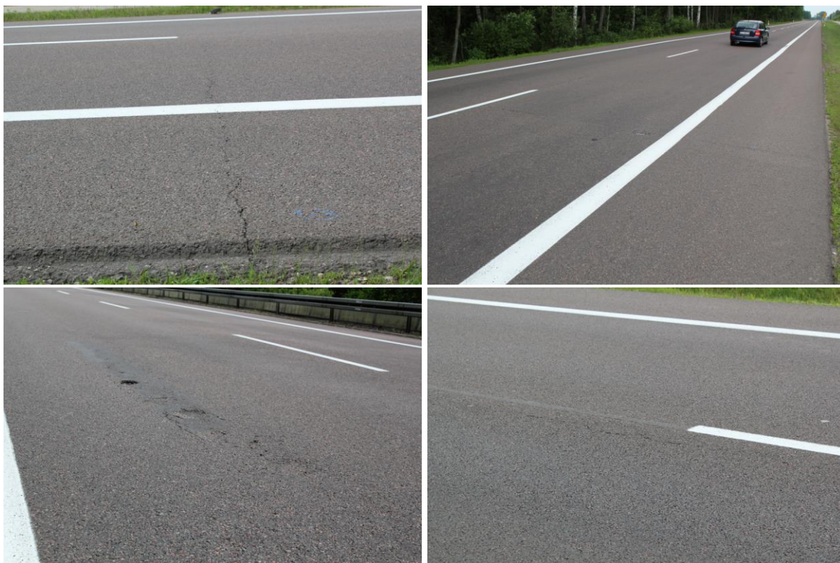
Rysunek C.12. Stan nawierzchni odcinka DK8 oceniony w roku 2012 a) spękanie poprzeczne o średniej szkodliwości; b) spękanie poprzeczne z lokalnymi wykruszeniami, duża szkodliwość c) uszkodzenia powierzchniowe d) spękania podłużne o średniej szkodliwości
