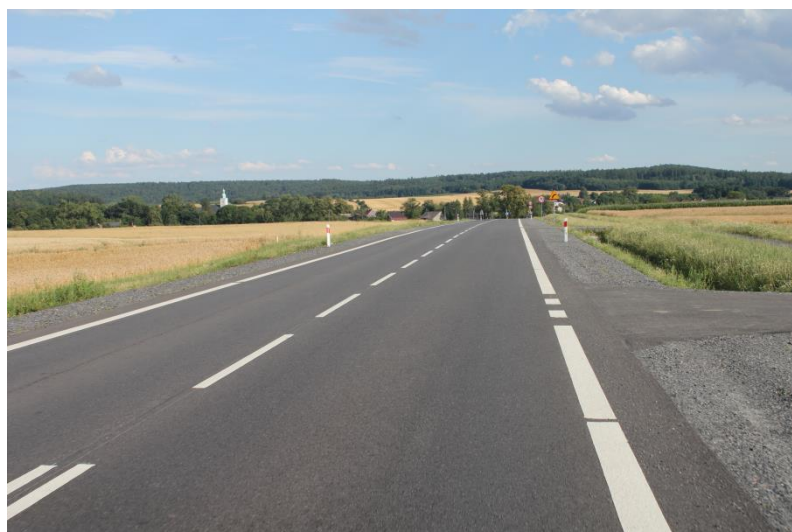
Rysunek C.8. Stan nawierzchni odcinka DK45 oceniony w roku 2012 (spękanie poprzeczne)
