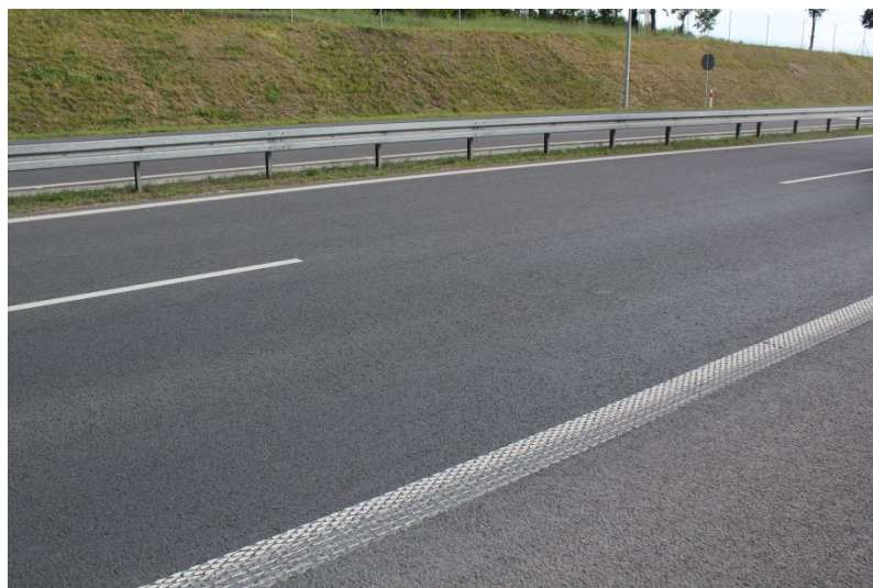
Rysunek C.16. Stan nawierzchni odcinka DK19 oceniony w roku 2012 (spękanie poprzeczne)
