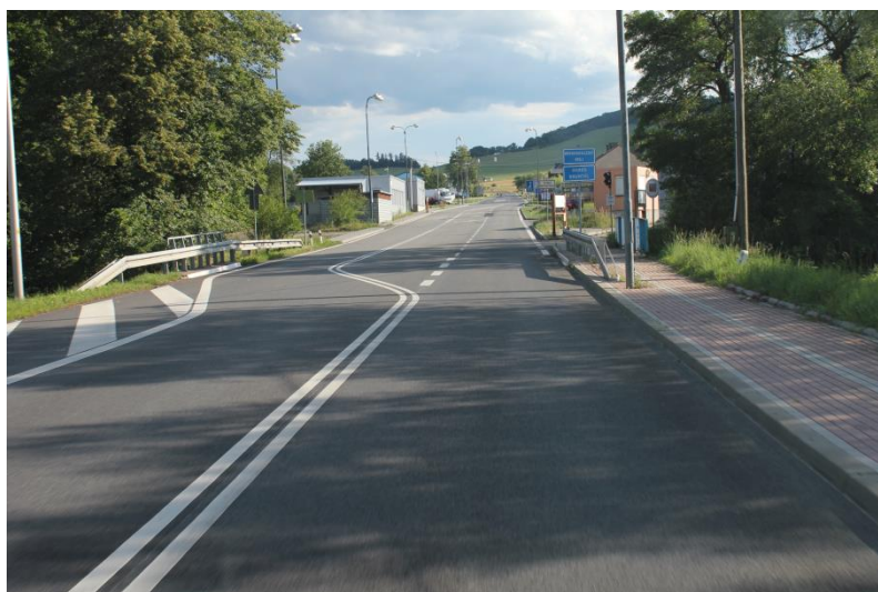
Rysunek C.7. Stan nawierzchni odcinka DK41 oceniony w roku 2012
