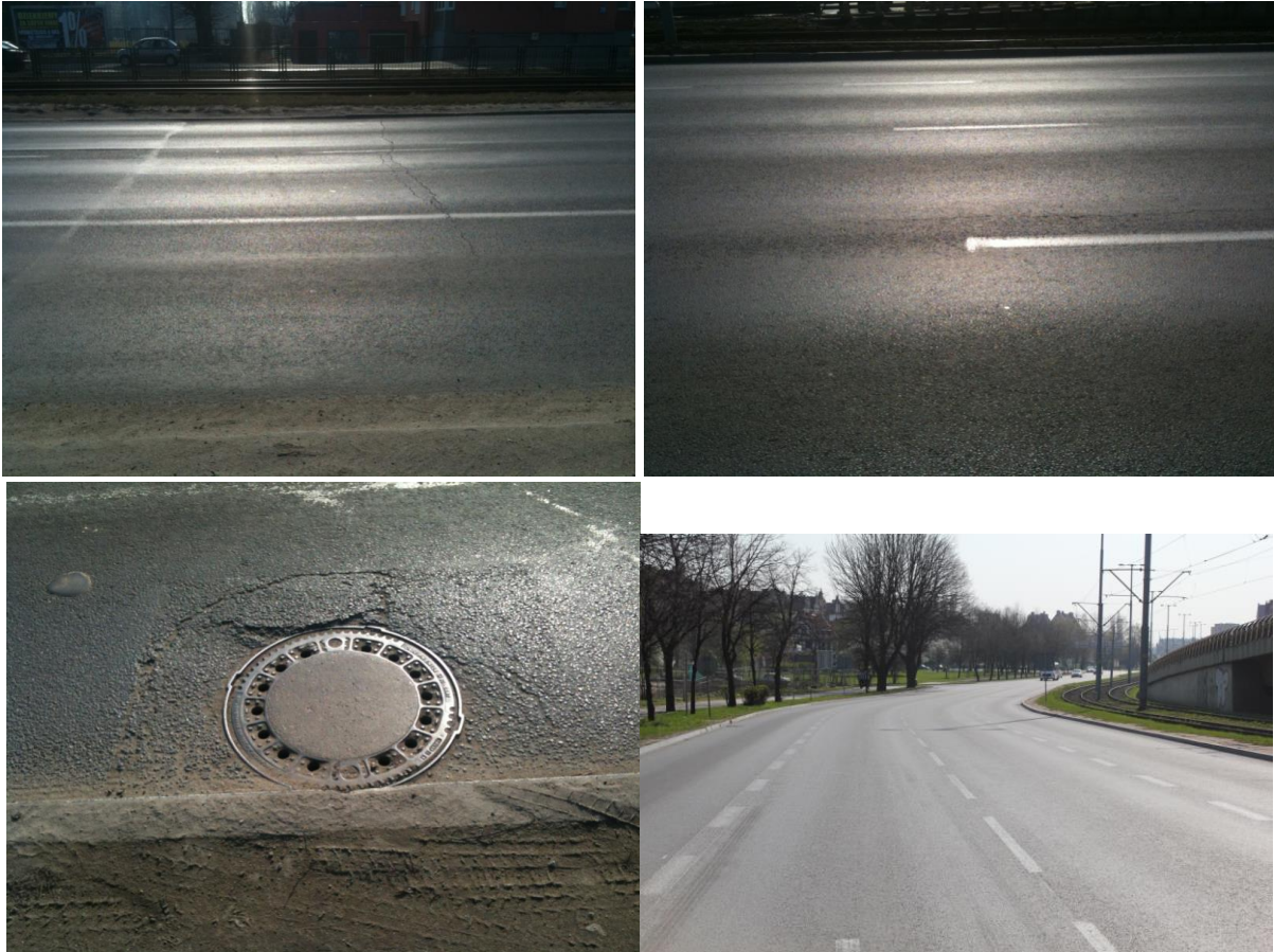
Rysunek C.18. Stan nawierzchni odcinka DK7 oceniony w roku 2012 a) spękania poprzeczne na połączeniu z istniejącą nawierzchnią; b) spękania podłużne; c) uszkodzenia powierzchniowe w obrębie studni; d) widok ogólny
