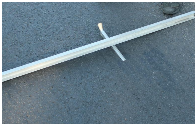
Rysunek C.26. Koleina o głębokości 18 mm na odcinku drogi przed sygnalizacją świetlną
