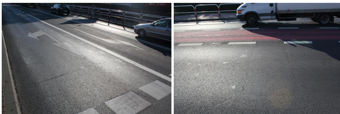
Rysunek C.25. Nawierzchnia przed sygnalizacją świetlną, widoczne spękanie poprzeczne oraz koleina
