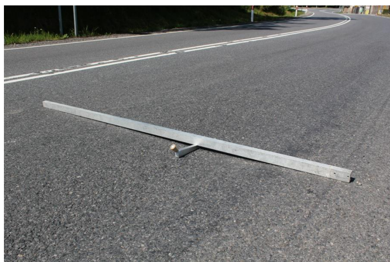
Rysunek C.6. Stan nawierzchni odcinka DK46 oceniony w roku 2012 (koleina – łąta długości 2 m; odcinek A)
