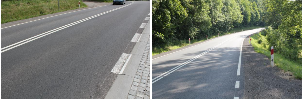
Rysunek C.4. Stan nawierzchni odcinka DK46 oceniony w roku 2012 (spękanie poprzeczne)
