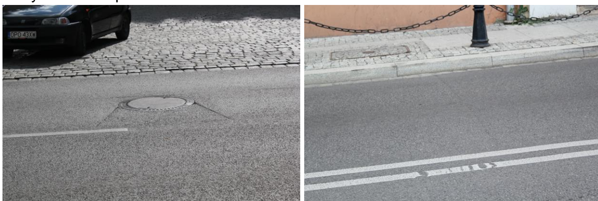
Rysunek C.9. Stan nawierzchni odcinka 20020 oceniony w roku 2012 a) uszkodzenia w obrębie studni b) spękanie poprzeczne
