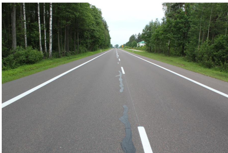
Rysunek C.13 Stan nawierzchni odcinka DK8 oceniony w roku 2012, zalane spękania podłużne
