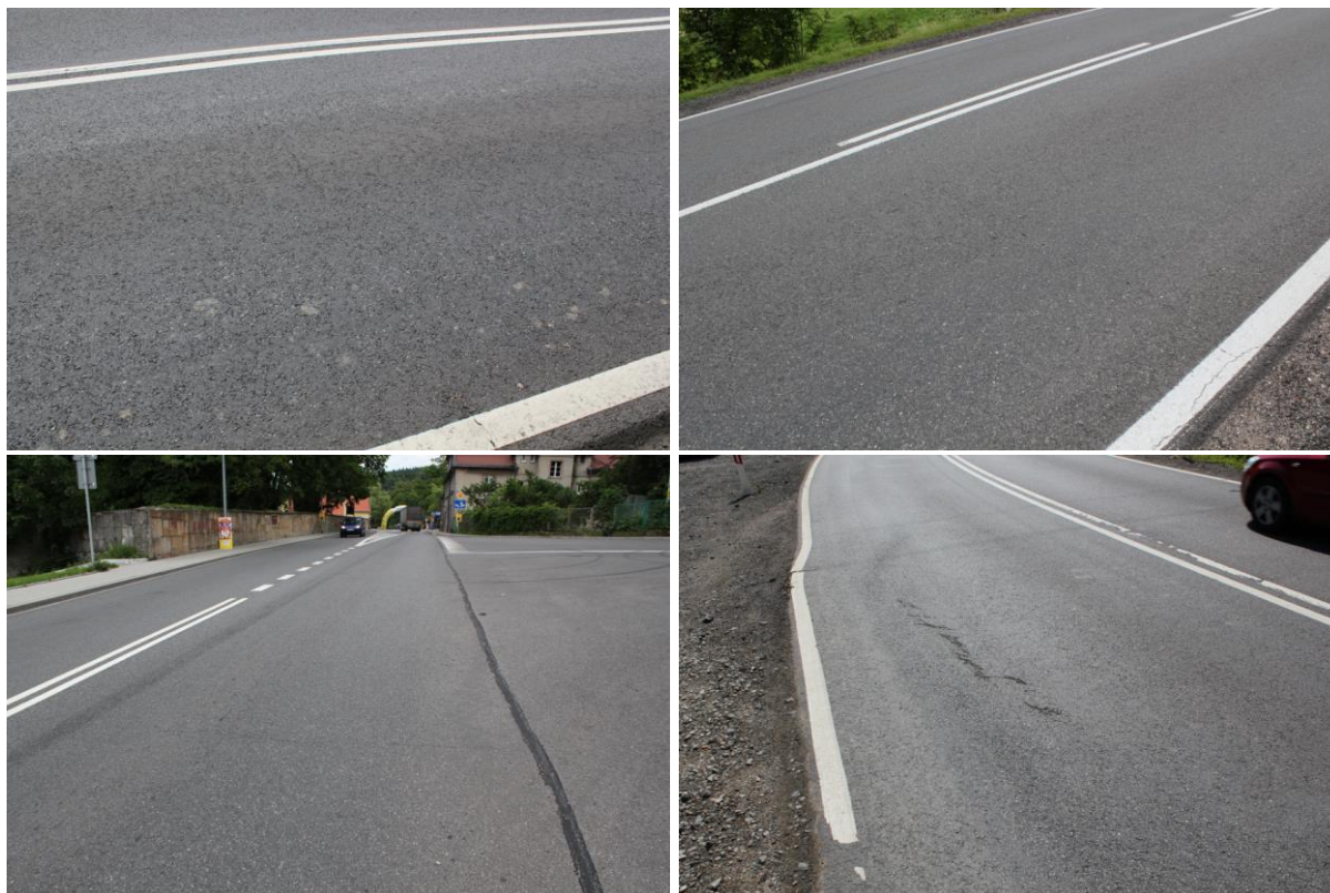
Rysunek C.5. Stan nawierzchni odcinka DK46 oceniony w roku 2012 a) spękanie poprzeczne; odcinek A, b) spękanie poprzeczne; odcinek B; c) spękanie poprzeczne; odcinek C; d) uszkodzenia powierzchniowe; odcinek A
