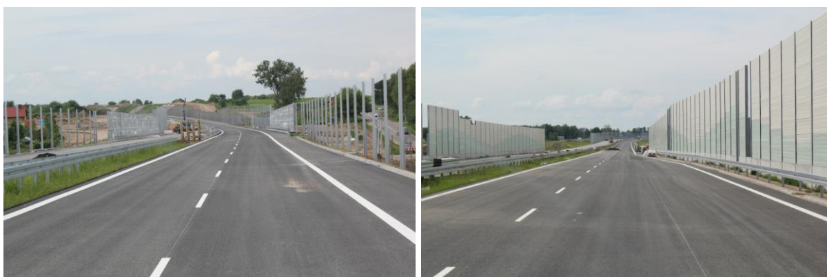
Rysunek C.11. Stan nawierzchni odcinka S8 oceniony w roku 2012
