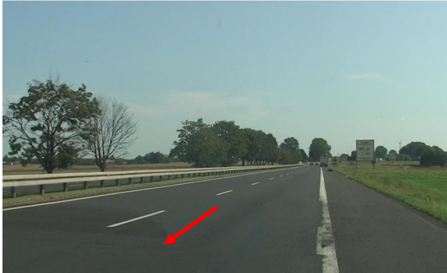
Rysunek C.30. Widok nawierzchni drogi krajowej 92 w km 210+200, widoczne spękanie poprzeczne
