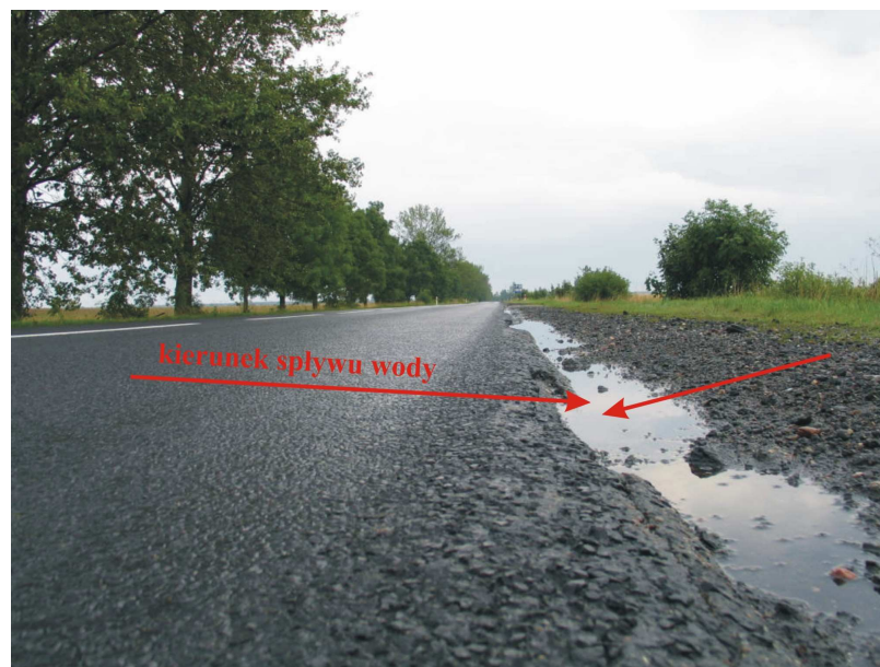
Rysunek 15 Zatrzymanie spływającej z nawierzchni wody przy krawędzi jezdni przez źle wyprofilowane pobocze
