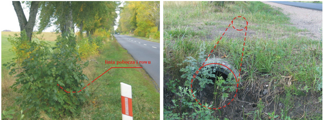
Rysunek 17 Brak systematycznego utrzymania rowów i urządzeń odwadniających powoduje poważne zakłócenia w prawidłowym odwodnieniu nawierzchni
