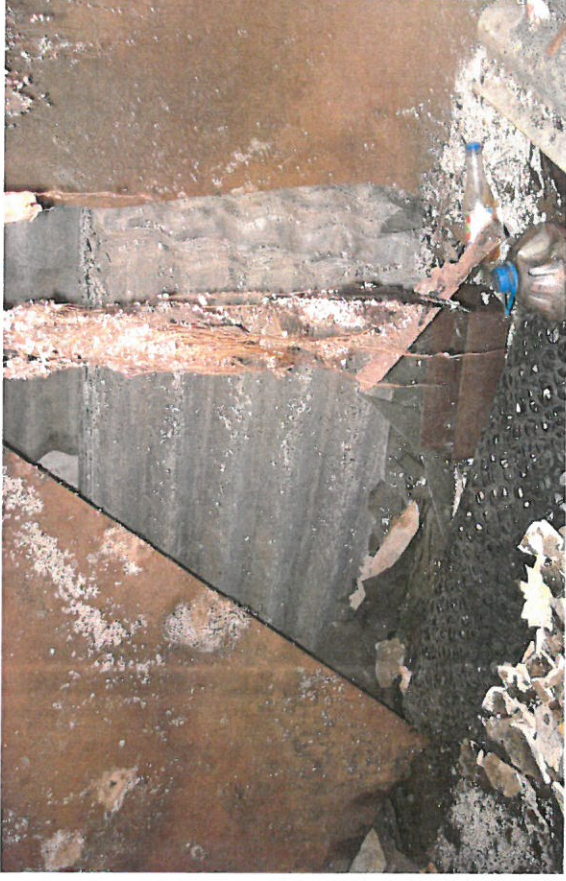
Fot. 2 Płyty azbestowe – cementowe składowane wewnątrz altanki
