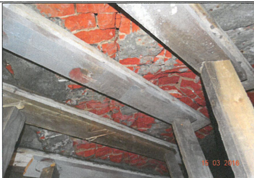
Fot. 16 Tymczasowa konstrukcja wsporcza zabezpieczająca sklepienie łuku - występują ubytki spoinowania, pęknięcia cegół wraz z wykruszeniem.
