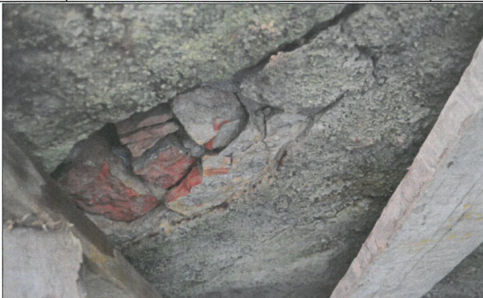
Fot. 11 Uszkodzona konstrukcja nośna łuku, znacznie powiększające się pomimo podparcia pęknięcie wraz z przemieszczeniem materiału konstrukcyjnego.
