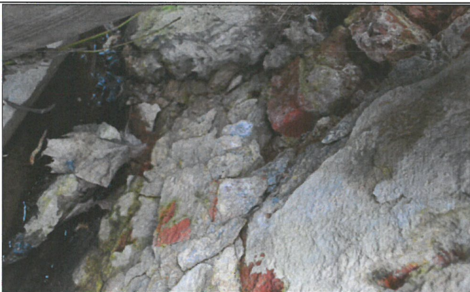
Fot. 10 Postępująca degradacja konstrukcji nosnej, świadczą o niej zwiększające się wykruszenia cegieł wraz ze spoinami.
