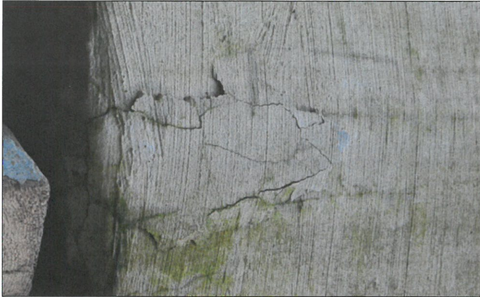
Fot. 13 Postępujący proces degradacji liczne spekania na całej powierzchni obiektu.
