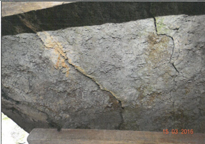
Fot. 14 Pęknięcia podłużne konstrukcji świadczące o jej przeciążeniu.
