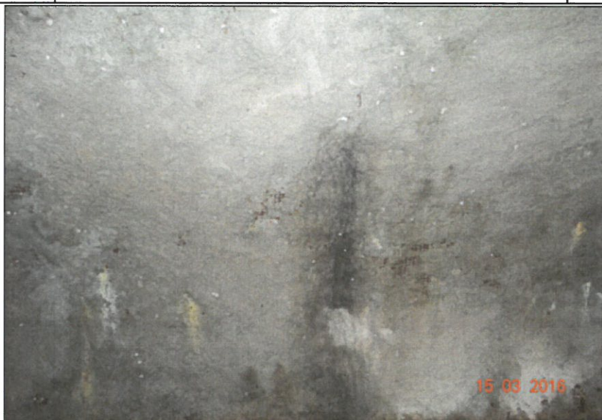
Fot. 17 Liczne zacieki na ścianach obiektu świadczące o nieszczelności izolacji.
