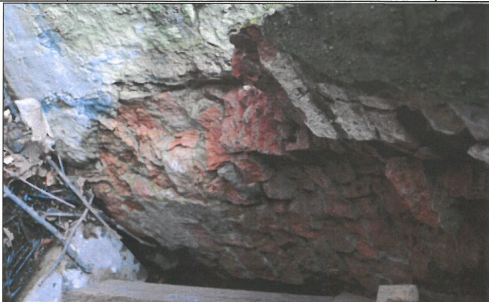
Fot. 9 Postępująca erozja materiału objawiająca się znacznymi ubytkami w konstrukcji.
