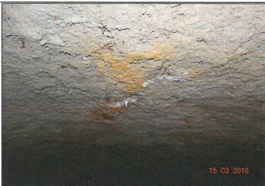
Fot. 18 Liczne nacieki węglańcu wapnia na sklepieniu i ścianach bocznych.
